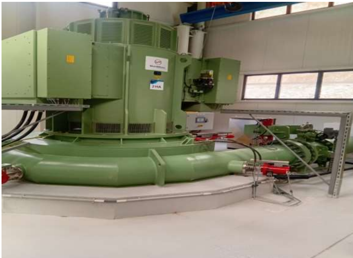
Şəkil 2 Meydan Kiçik Su Elektrik stansiyasında qoyulmuş Pelton hidroturbini və Marelli hidrogeneratoru
